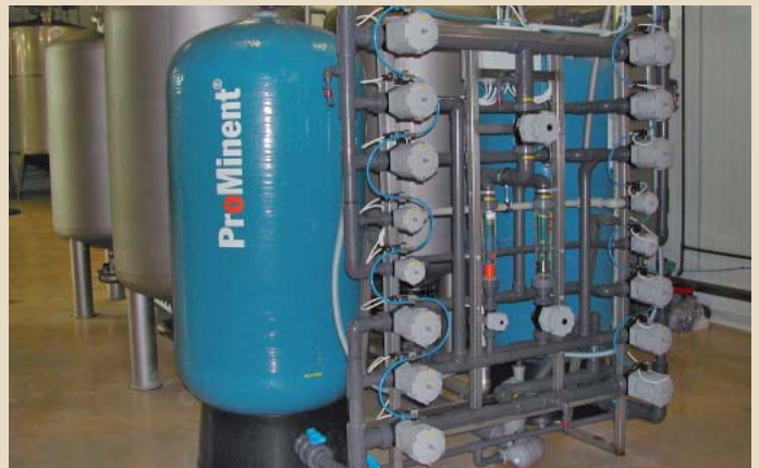
Enthärtungsanlage in einem Getränke herstellenden Betrieb
